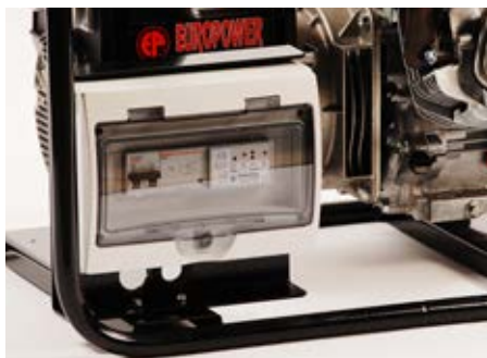
Isolasjonskontroll med termomagnetisk vern
